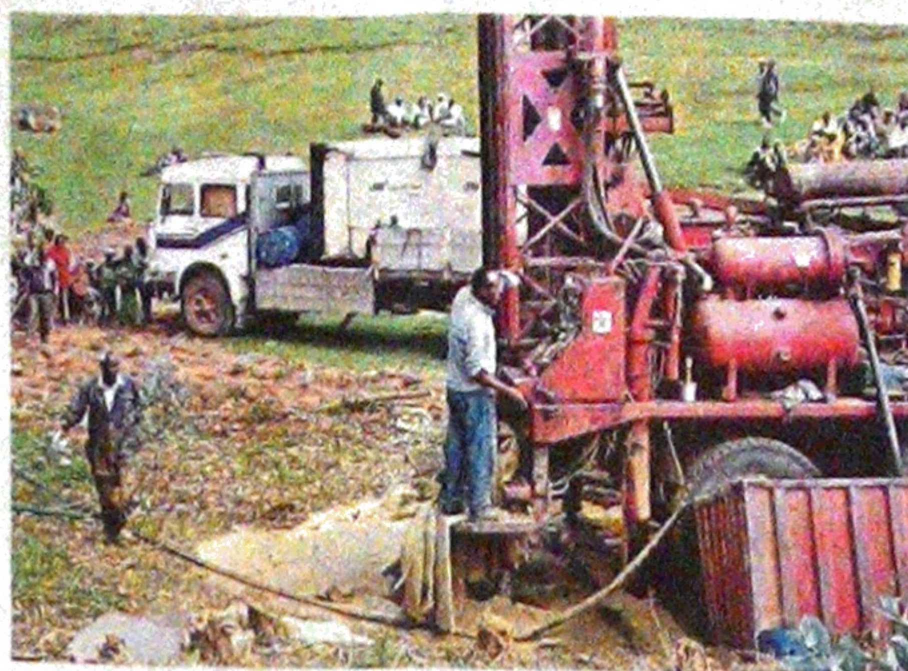
Stavba studny v Etiopii, na které se Češi podílejí FOTO ČLOVĚK V TÍSNI
