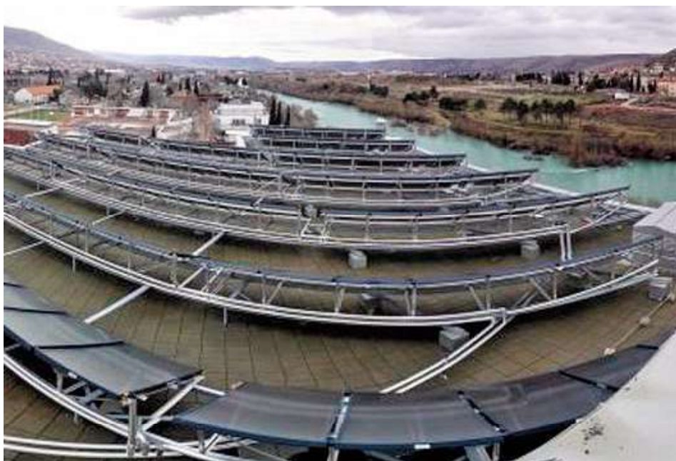
Česká rozvojová agentura se podílela i na realizaci projektu na solární ohřev vody v nemocnici v bosenském Mostaru. FOTO: CZECHAID.CZ
