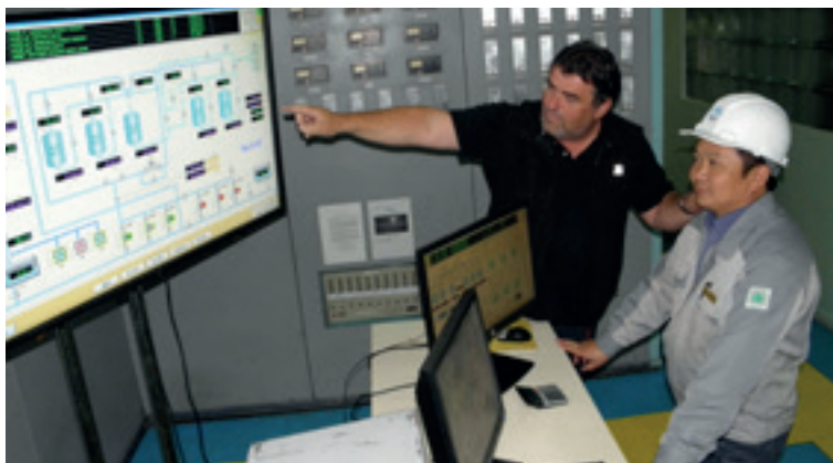
Mongolsko: Modernizace velínu elektrárny č. 4 v Ulánbátaru
